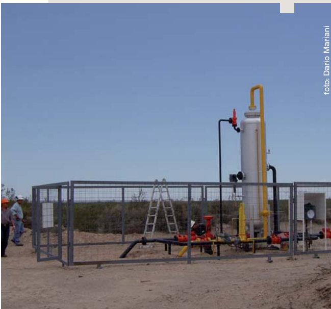
Equipo separador gas-petróleo. Todos los caños amarillos son de gas y los negros de petróleo.
