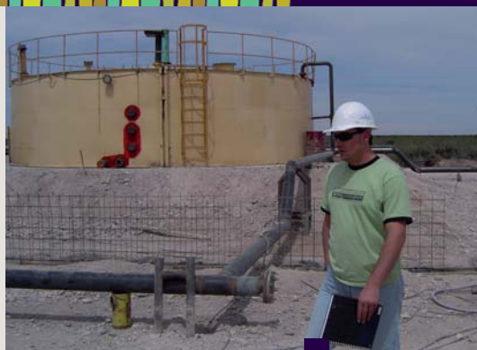
Tanque de almacenamiento de petróleo crudo.
