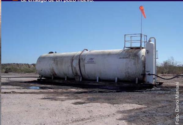
Derrame de petróleo en tanque provisorio de ensayo de un pozo nuevo.
